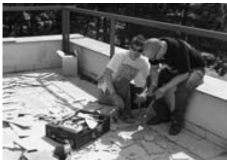
Štěpán Exner a Martin Slouka při odsekávání keramické dlažby na terase. Zatekání bylo úspěšně zabráněno.
